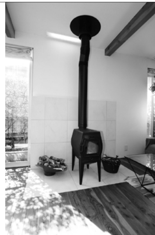
2階リビングに設置された薪ストーブ
