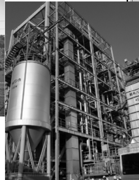
東海パルプに導入されたバイオマスボイラー→
